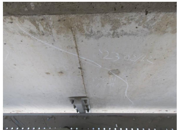
교각 균열(0.3mm미만) P2
