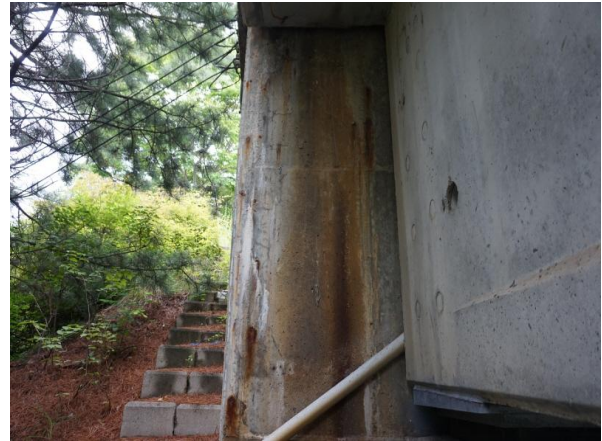
교대 망상균열 및 백태 A2
