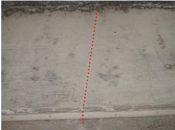
가로보 균열(0.3mm미만) S4 G3~G4 CB3
