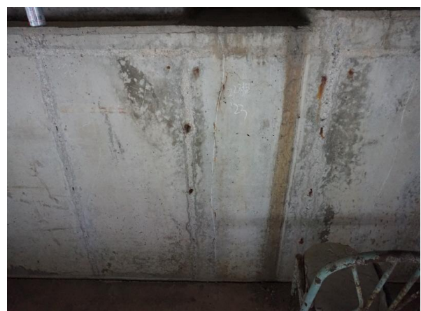
교대 균열(0.3mm미만) A2
