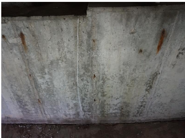
교대 균열(0.3mm이상) A2
