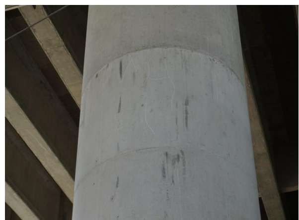
교각 망상균열 P3
