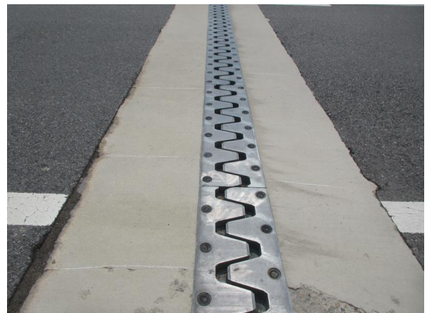
후타재 균열 Exp.Joint-P2
